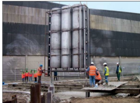
Vpravo: Priepustná reaktívna bariéra (foto archív Menard)
